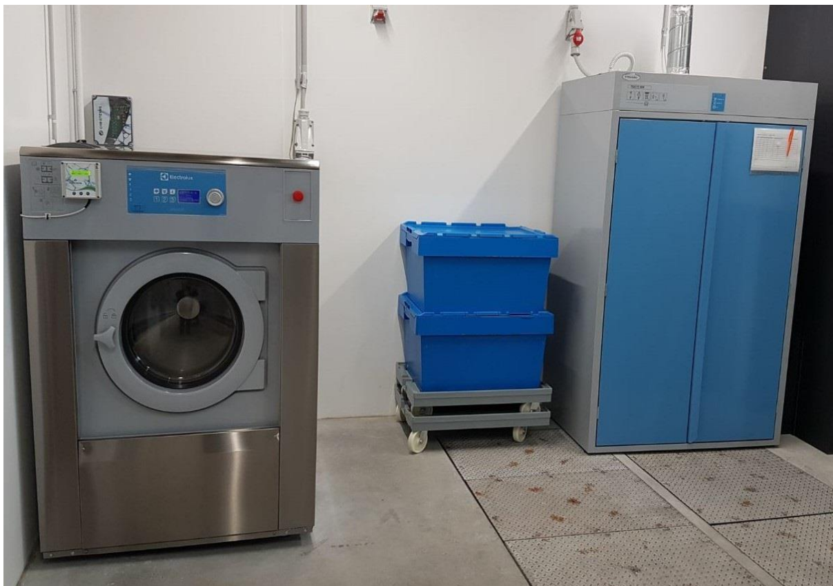
Bild 1. Tvättrum på brandstation med tvättmaskin och torkskåp för larmställ och andningsapparater
